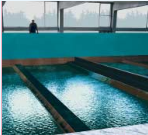
Trinkwasseraufbereitung im Wasserwerk Hamburg-Walddörfer.
